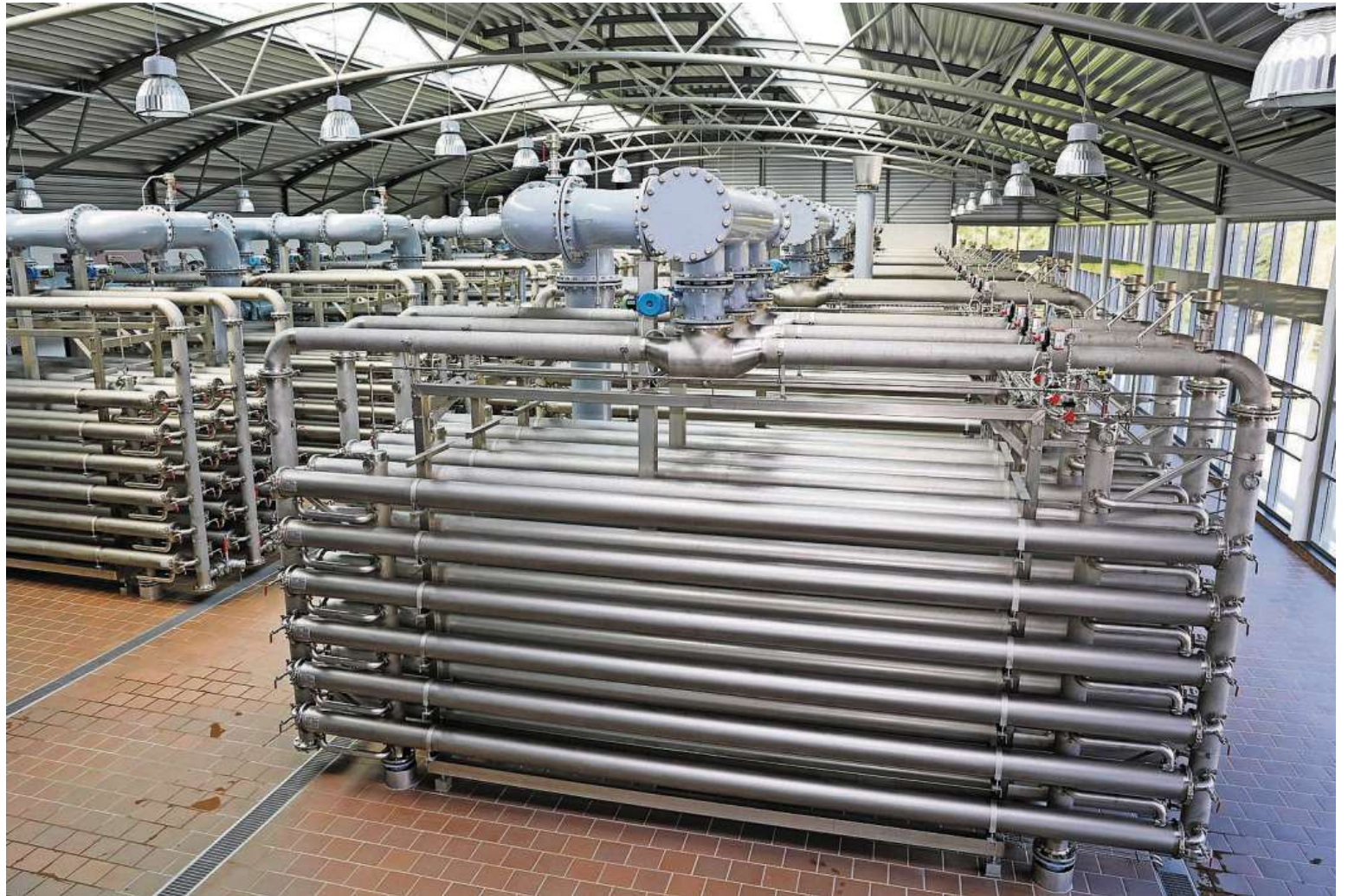
Moderne Aufbereitungstechnik sichert die hohe Qualität des Trinkwassers aus der Dreilägerbachtalsperre.
